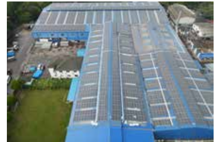
Mega Roof Solar Project-Swissteck Aluminium Ltd
